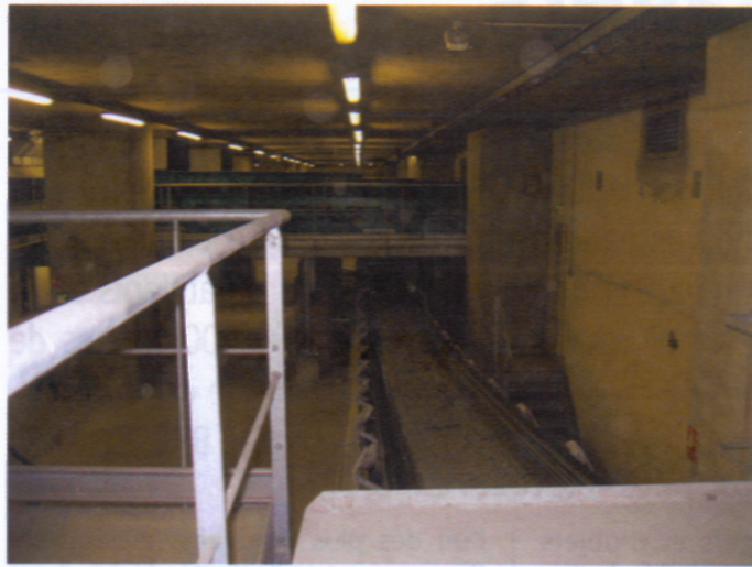
► Les scalpeurs vibrants SCHENCK alimentent un convoyeur à bande BRESCHARD / The SCHENCK linear vibrating screens feed a BRESCHARD belt conveyor.
